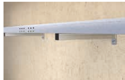
Chemin de câbles fixé par consoles
