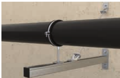
Tuyauterie lourde d'eaux usées sur console
