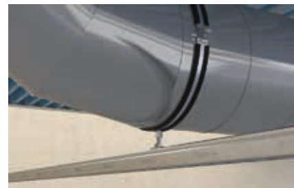
Structures portantes pour installations de ventilation
