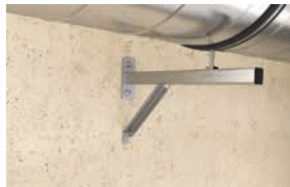
Fixation murale de gaines de ventilation
