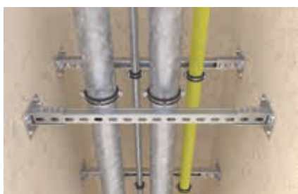
Fixation de tuyaux d'évacuation
