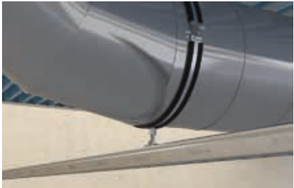
Structures portantes pour installations de ventilation
