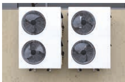
Unités de climatisation
