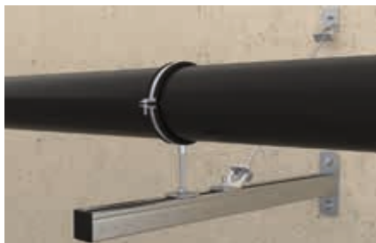
Tuyauterie lourde d'eaux usées sur console
