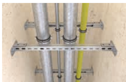
Fixation de tuyaux d'évacuation
