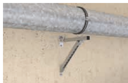
Gaine de ventilation sur console
