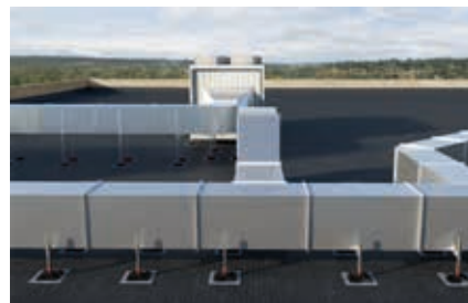
Réseau d'air conditionné
