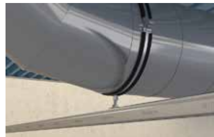
Structures portantes pour installations de ventilation
