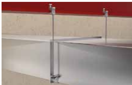
Conduit de ventilation sous poutre métallique avec pince à poutrelle
