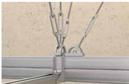
Haubanage de rails pour plafonds techniques
