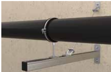
Tuyauterie lourde d'eaux usées sur console
