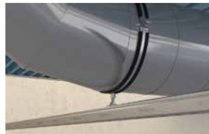
Structures portantes pour installations de ventilation
