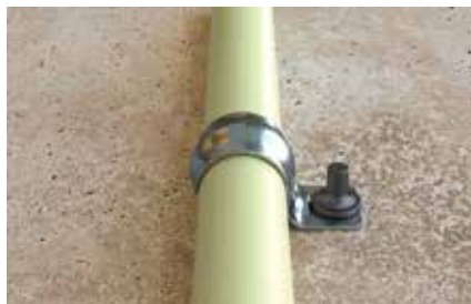
Fixation de conduites blindés
