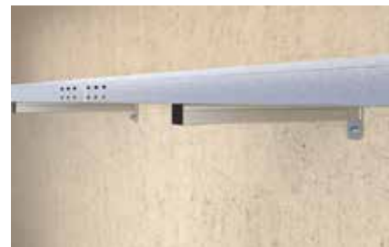
Chemin de câbles fixé par consoles
