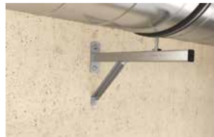
Fixation murale de gaines de ventilation
