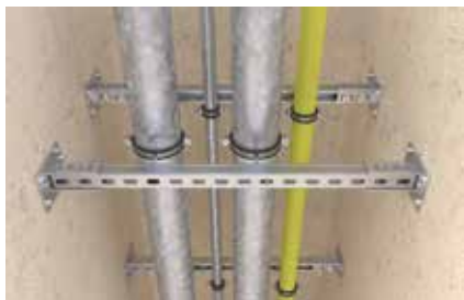
Fixation de tuyaux d'évacuation
